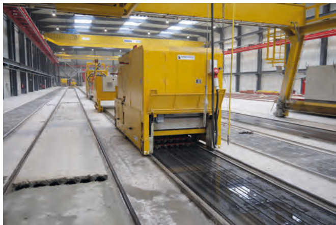
Extruder per la produzione di pannelli alveolari nella fabbrica di Malle
